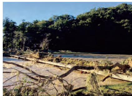
令和元年東日本台風時の鞍掛橋(神戸)
