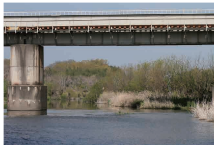
調査地最下流部の東松山橋から上流を眺望する・橋は東上線鉄橋
