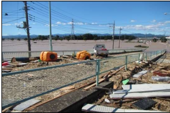
令和元年東日本台風 (県道岩殿観音南戸守線 早俣橋)
