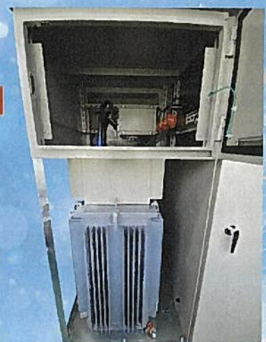
昇圧変圧器盤 内部(裏面)
