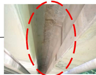
床版(間詰め部)の漏水
