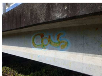
主桁の落書き
