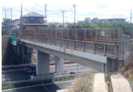
西本宿二号橋（健全度Ⅲ）
