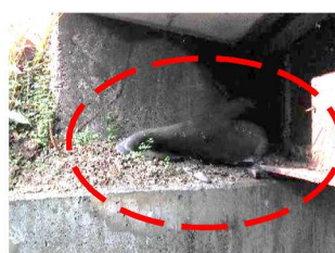
目地材の脱落
