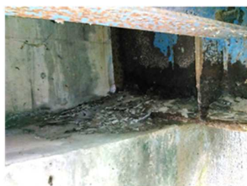
支承部の土砂堆積
