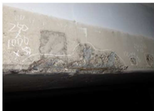
主桁の鉄筋露出
