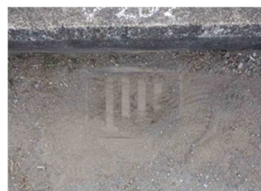
排水ますの土砂詰まり
