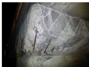
橋脚のうき,鉄筋露出
