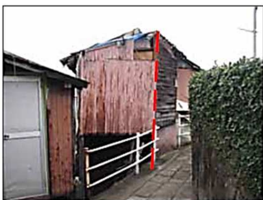
一部の柱が傾斜している例（評点25）
