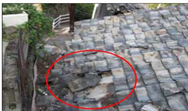
瓦の一部に剥離とズレがあり、 雨漏りのある例（評価点 1 5）
