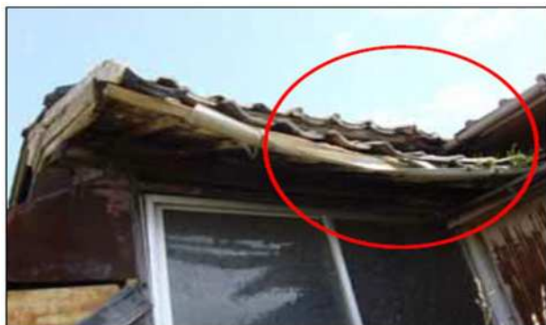
軒の裏板、たる木等が腐朽し、 軒が垂れ下がっている例（評価点 2 5）
