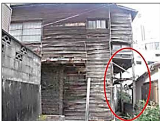
柱の数箇所に破損がある例（評点50）
