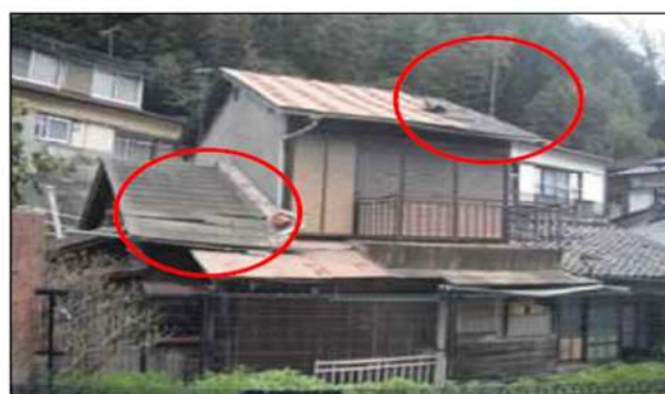
屋根ぶき材料の一部にズレがあり、 雨漏りのある例（評価点 1 5）
