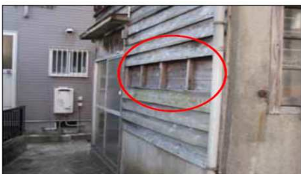
外壁の仕上材の一部がはがれ、 下地が露出している例（評価点 1 5）
