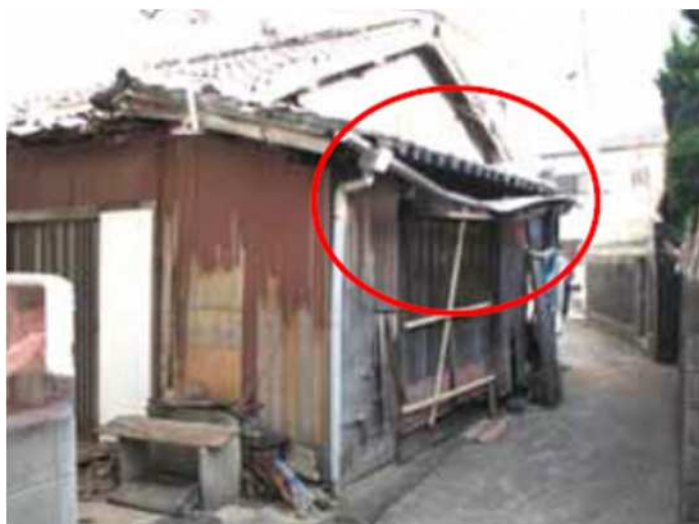
雨樋が壊れており、機能的には 雨樋がないと同様の例（評価点10）
