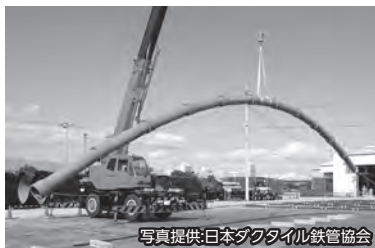
写真提供:日本ダクタイル鉄管協会
