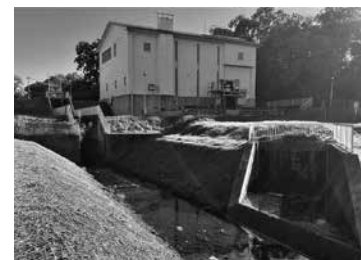
雨水ポンプ場 (自然に流れない雨水を川に排出する施設)
