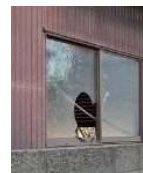
窓が割れた 管理不全空家
