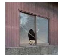
窓が割れた管理不全空家
