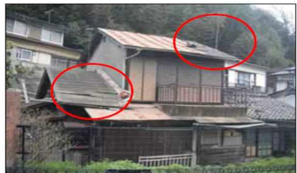
屋根ぶき材料の一部にズレがあり、 雨漏りのある例（評点 1 5）
