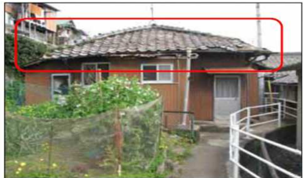
屋根に不陸（凹凸）がある例（評点 5 0）
