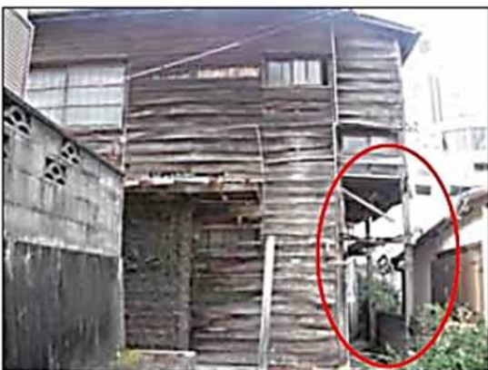
柱の数箇所に破損がある例（評点50）
