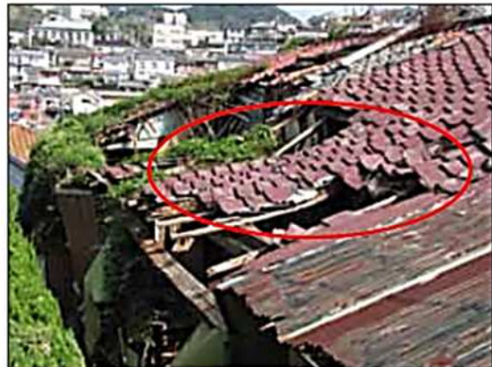
柱、はりの破損や変形が著しく崩壊の危険がある例（評点100）
