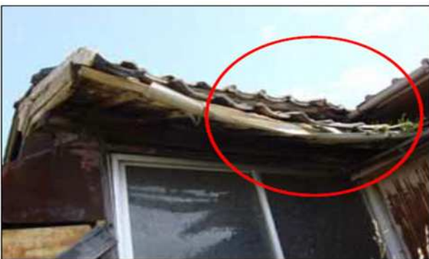
軒の裏板、たる木等が腐朽し、 軒が垂れ下がっている例（評点 2 5）
