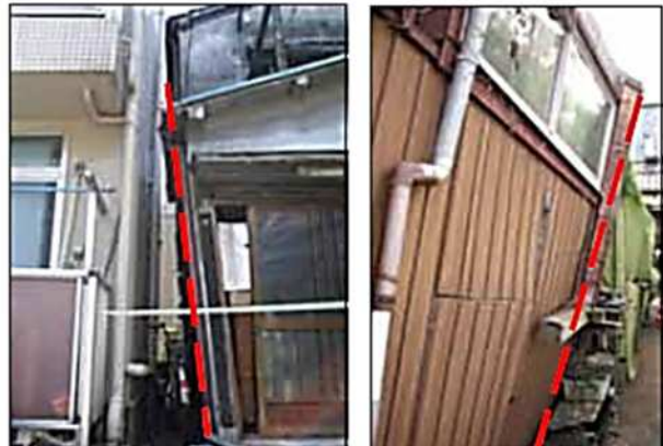
柱の変形が著しく崩壊の危険がある例（評点100）
