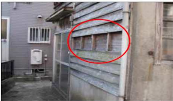
外壁の仕上材の一部がはがれ、 下地が露出している例（評点 1 5）
