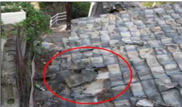
瓦の一部に剥離とズレがあり、 雨漏りのある例（評点 1 5）
