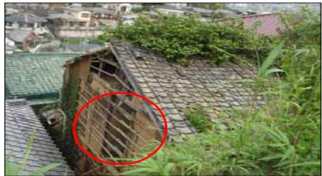
外壁が剥落し、著しく下地が露出するとともに、 壁体を貫通する穴を生じている例（評点 2 5）
