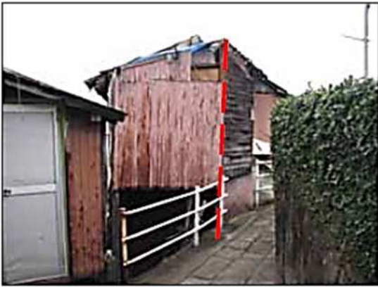
一部の柱が傾斜している例（評点25）
