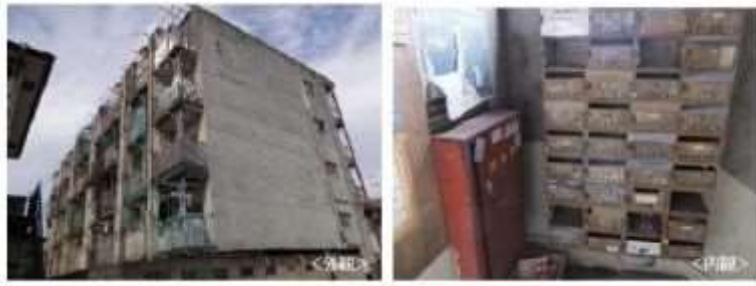
建物の痛みが著しく外壁の崩落、鉄骨の露出などが見られる事例 (出典：国土交通省資料)
